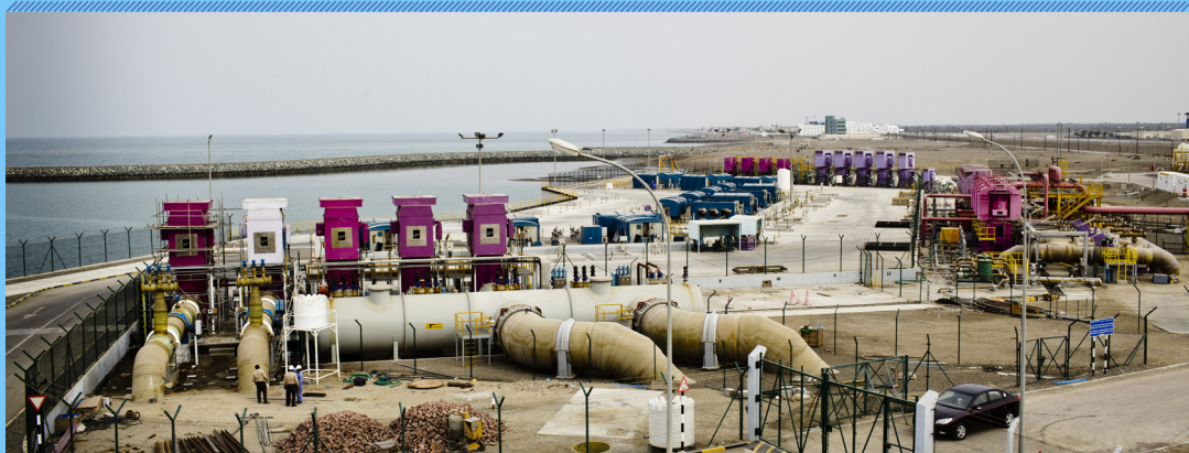
Instalaciones hidráulicas del Puerto de Sohar, Omán.
