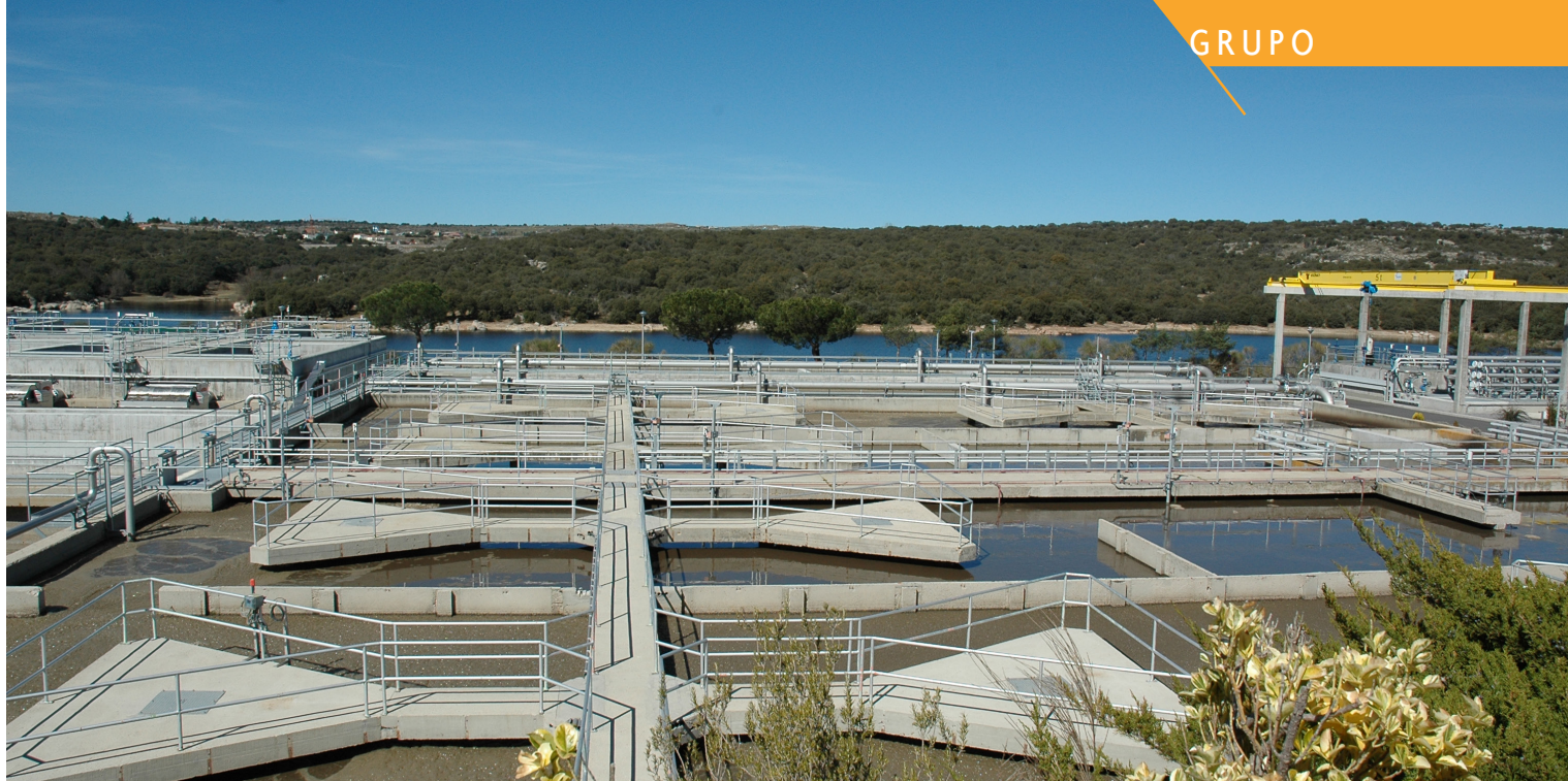
Estación depuradora de Ávila.
